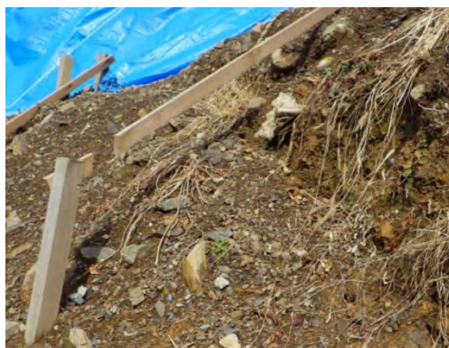
図XI-2.2.5 地表面の亀裂（抜き板による簡易的な監視例）
