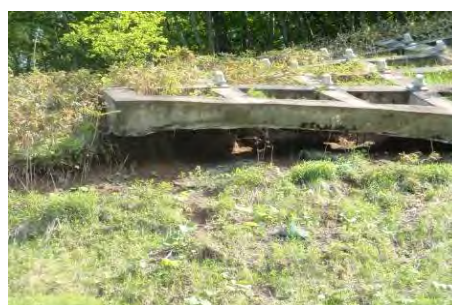
「地表の沈下」(滑落崖の形成)
