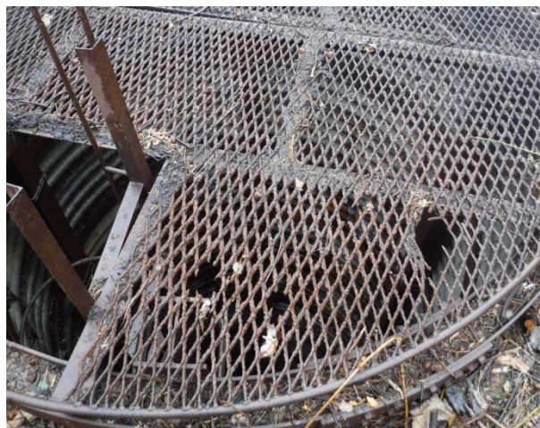
図 6.3 集水井工の蓋の損傷・劣化事例
