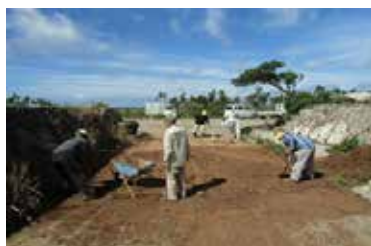
赤土流出箇所は 住民一丸で早急に対処
