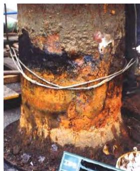
図 2.1.14 吸込配管の腐食の例
