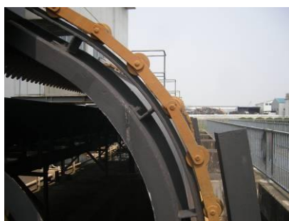
写真 2.2 ガイドレールの R 部レールの摩耗
