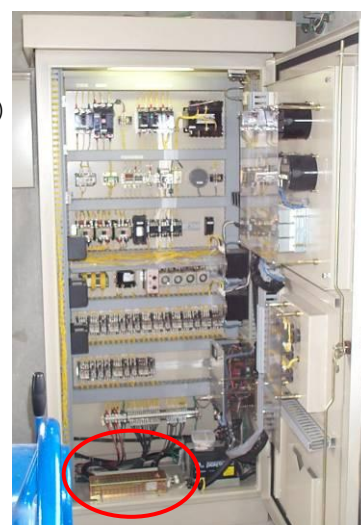
写真 12.1 操作盤内のスペースヒータ（例）
