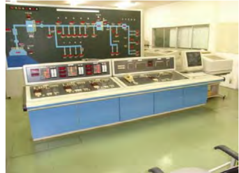
図4.2-9 監視盤及び操作卓
