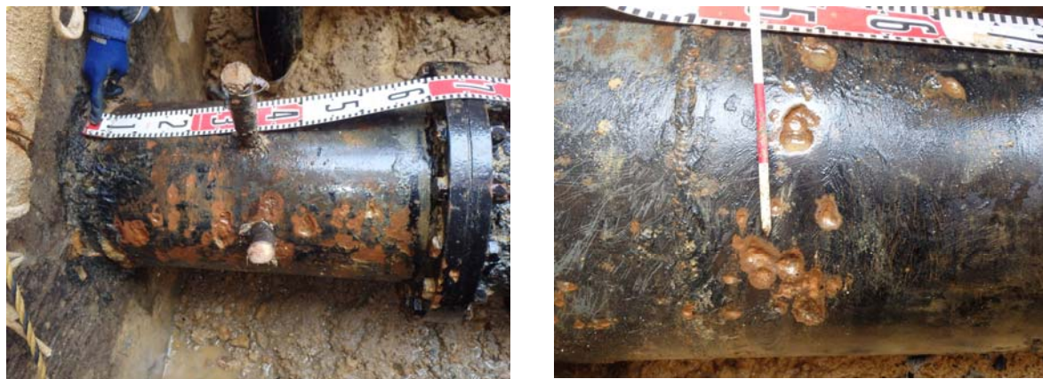
図 2.4-1 メタルタッチに伴う C/S マクロセル腐食例
