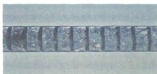
腐食度区分：腐食なし又は0
