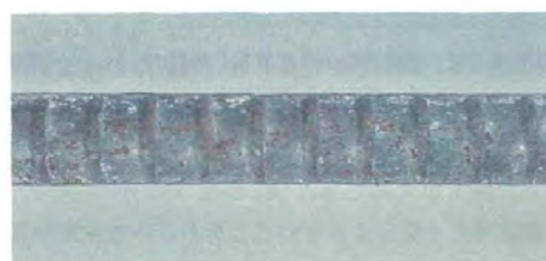
腐食度区分：A又はI
