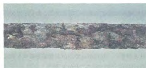
腐食度区分：D又はIV
