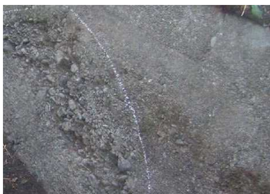
図 3. 2-7 開水路側壁の豆板
