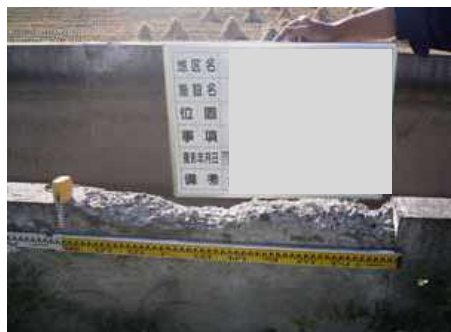
図 3.3-8 側壁天端に生じたスケーリング
