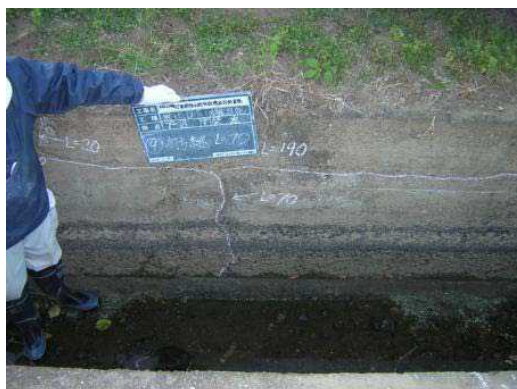
図 3. 2-8 開水路側壁のコールドジョイント
