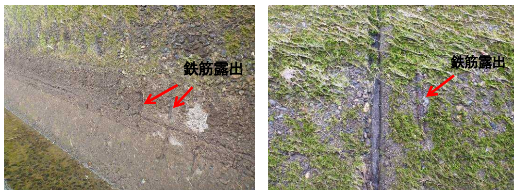
図 3.2-9 かぶり不足による鉄筋露出
