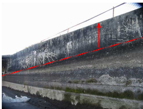
図 3.3-7 コンクリート開水路側壁喫水線上部に生じた凍害
