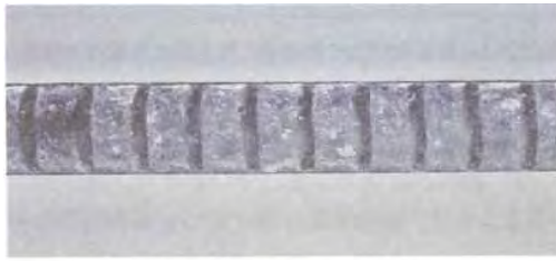
腐食度区分：腐食なし又は 0
