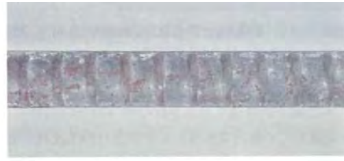
腐食度区分：A 又は I
