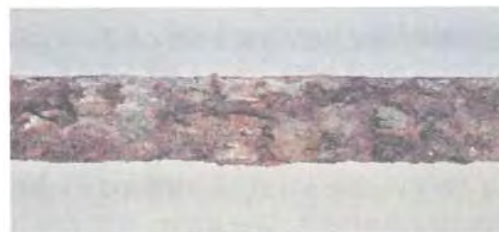
腐食度区分：D 又は IV
