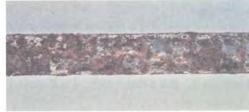
腐食度区分：C 又は III
