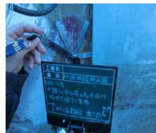
パネルと充填材の隙間最大0.6mm（パネル端部）
