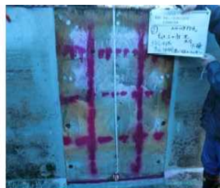
裏込め材の状況天端20cm程度中性化
