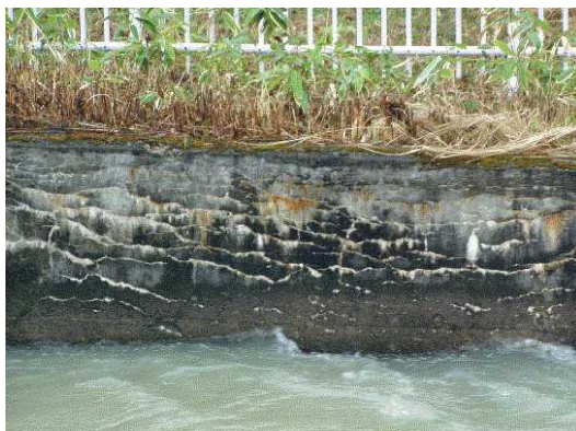
図 2.2-6 開水路側壁 (凍害によるひび割れ)
