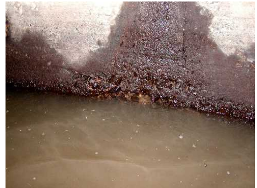
図 2.2-9 開水路側壁 (豆板)
