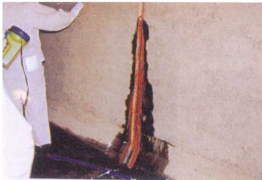
図 2.2-4 開水路側壁 (継目からの漏水)
