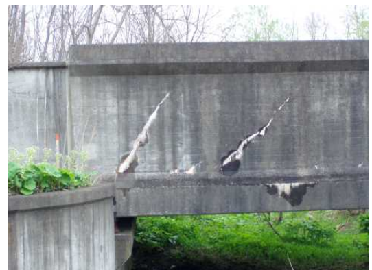
図 2.2-7 水路橋 (せん断力によるひび割れ)
