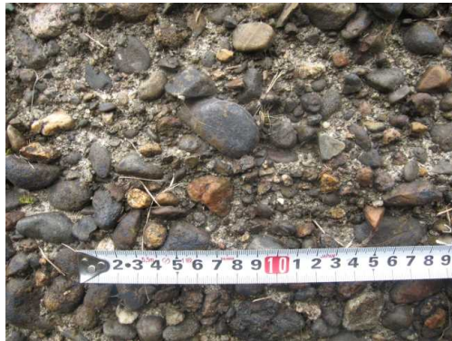
図 2.2-8 開水路側壁 (摩耗による骨材露出)
