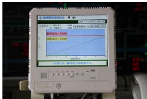
写真-5.1 デマンド監視装置の設置例
