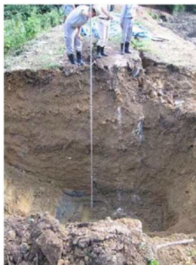
写真-f 亀裂確認状況（堤体開削）
