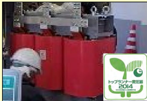
【高効率変圧器への更新】
