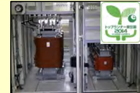
【高効率変圧器への更新】
