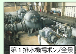
第1排水機場ポンプ全景
