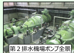
第2排水機場ポンプ全景
