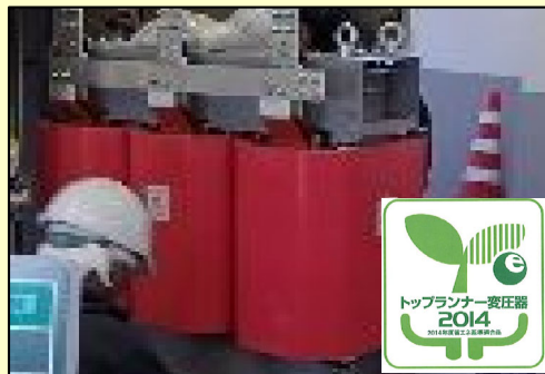
【高効率変圧器への更新】
