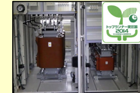
【高効率変圧器への更新】
