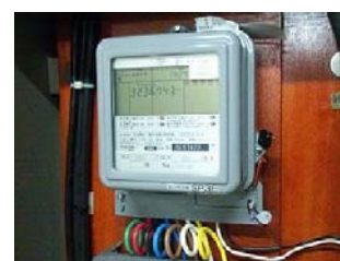
写真 1 30 分最大需要電力計 設置例 (精密級複合計器(東京電力))
