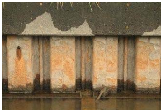
写真 1.2-1 腐食代が残存する鋼矢板水路の例
