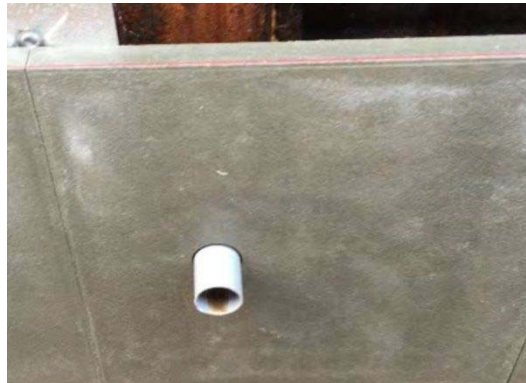
写真 5. 2-11 ウィープホールによる導水処理（例）
