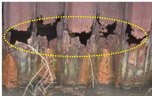
写真 1.2-4 ウェブが全体的に断面欠損した鋼矢板の例
