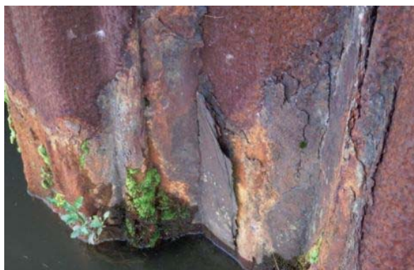
写真 1.1-1 鋼矢板の腐食状況（例）
