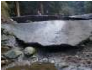
エプロン下の空洞化
