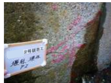
ひび割れのチョーキング例
