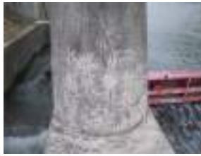
ひび割れ(凍害)
