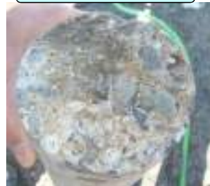
摩耗による粗骨材露出 空洞が想定される個所のコア
