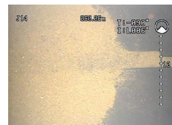
継手部堆砂状況
