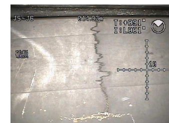
管内クラックの状況
