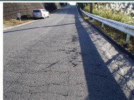
路面のひび割れ・沈下
