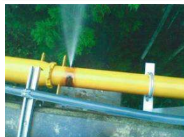
添架管部の漏水
