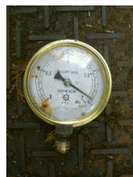
圧力計の故障
