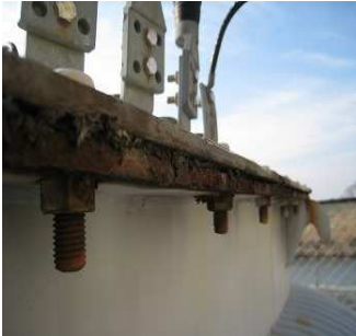
変圧器（屋外）の発錆
