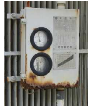
例；計器盤の発錆 塗装の剥がれ
