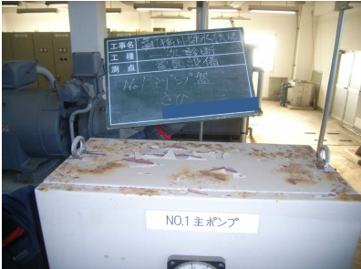
盤外面の塗膜劣化（錆、はがれ）
