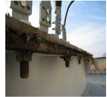
例；変圧器盤（屋外）の発錆
