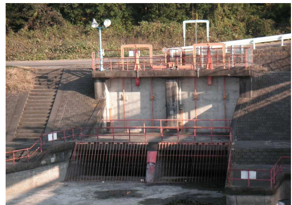
写真-6.1.2 頭首工の取水口ゲートの設置例
