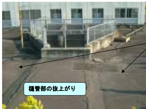
周辺地盤の沈下
