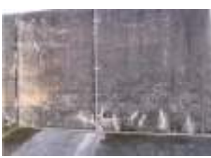
(吐水槽) ひび割れ
