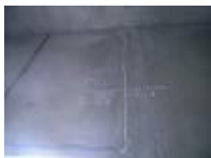
(内壁) ひび割れ
