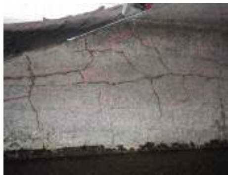
ひび割れのチョーキング例
