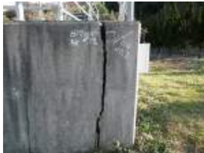
目地材欠落、周縁コンクリートの欠損
