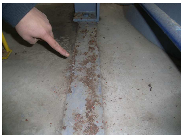
(4)ベース部 錆、塗膜のはがれあり（S-3）（劣化影響度はA）
