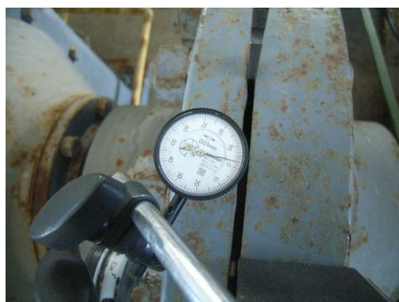
(4)軸継手部 芯振れ許容値以内（S-4）（劣化影響度はA）
