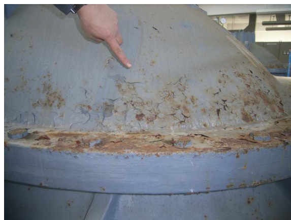
(2)ケーシング部 錆、塗膜のはがれあり（S-3）（劣化影響度はC）
