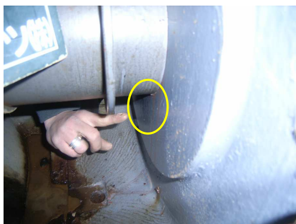
(3)軸受部 にじむ程度の油漏れあり（S-3）（劣化影響度はA）
