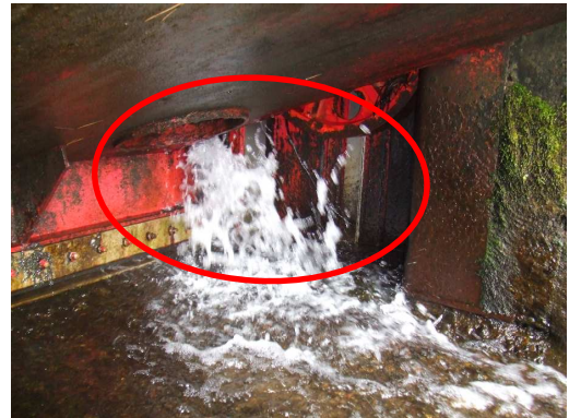
写真-6.2.5 扉体底部からの漏水状況
