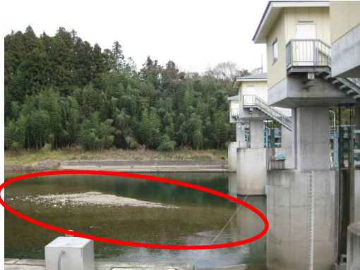
写真-6.2.2 ゲート上流部の堆砂状況
