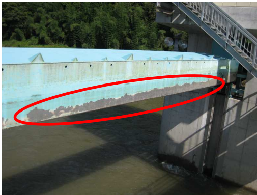
写真-6.2.4 扉体下部の塗装剥離状況
