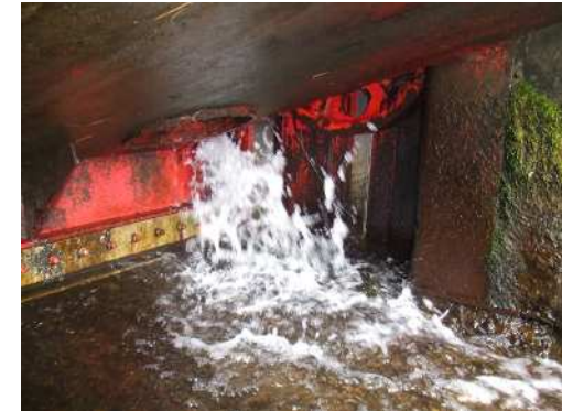
扉体底部からの漏水
