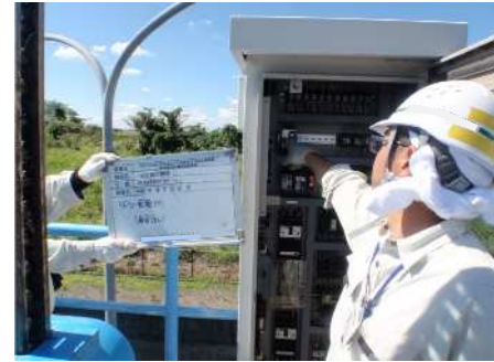
3E リレー（機側操作盤）動作確認
