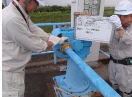
開閉装置（軸継手）の振動・加熱確認
