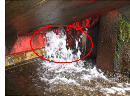
例：扉体底部からの漏水状況
