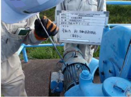
開閉装置（電動機）の異常音確認
