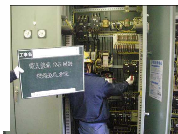
絶縁抵抗測定状況
