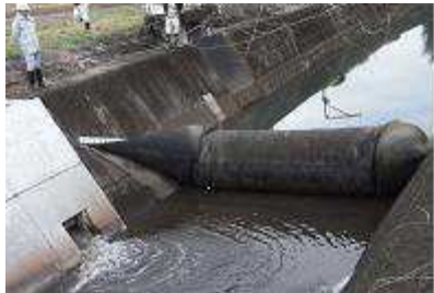
袋体下流側（起伏時）
