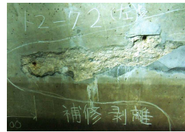
コンクリートの剥落・欠損
