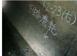
摩耗・骨材露出
