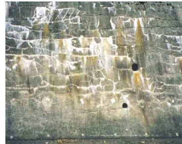
錆汁とゲル（析出物）
