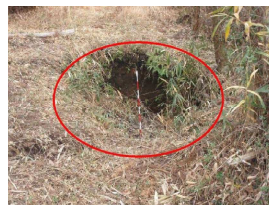
地盤の崩落・陥没
