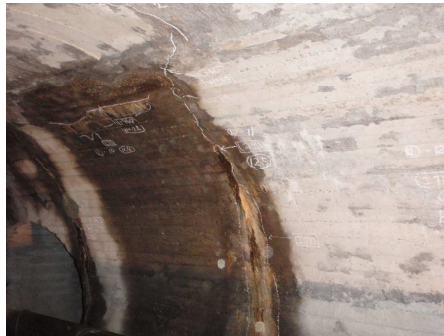
ひび割れのチョーキング例
