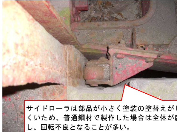
写真-6.1.12 サイドローラの腐食の例
