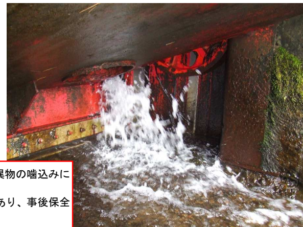
写真-6.1.14 水密不良による漏水の例
