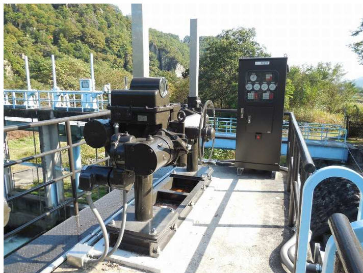
写真-6.1.6 ラック式開閉装置の事例写真
