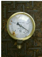
圧力計の故障
