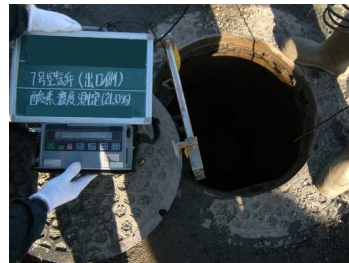
ガス検知器による事前確認
