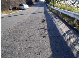
路面のひび割れ・沈下
