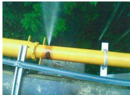
添架管部の漏水
