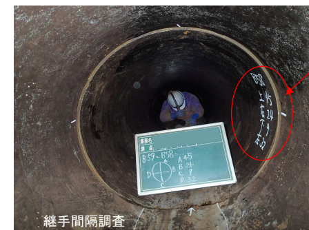
その他の変状（調査）のチョーキング例
