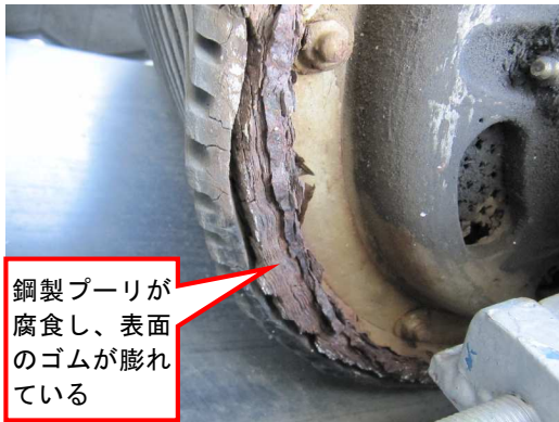
写真-9.1.8 駆動プーリ（電動機内蔵）の腐食例
