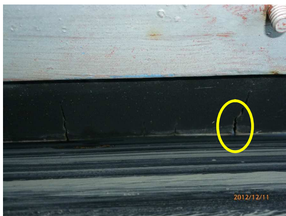
写真-9.1.11 スカートゴムの劣化によるひび割れの例
