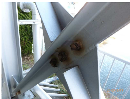
写真-9.1.13 接合部（ボルト）の腐食の例
