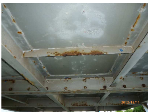
写真-9.1.12 フレームの腐食の例
