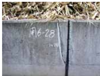
写真 周縁コンクリートの欠損
