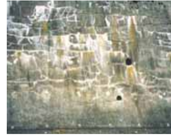
錆汁とゲル（析出物）
