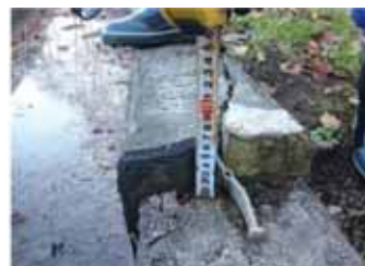
写真 止水板部から生じたひび割れ
