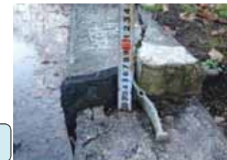
目地部の段差
