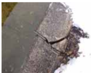
写真 止水板の破断
