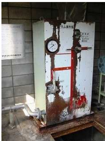
写真-7.1.14 操作装置全体の腐食の例
