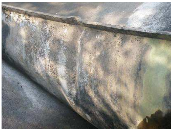
写真-7.1.6 袋体外面の全体的な劣化の例
