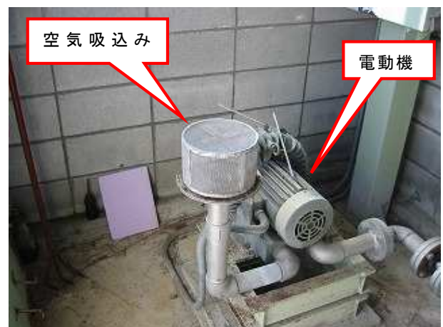
写真-7.1.15 電動機の発熱の例
