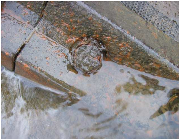
写真-7.1.12 取付金具の腐食の例
