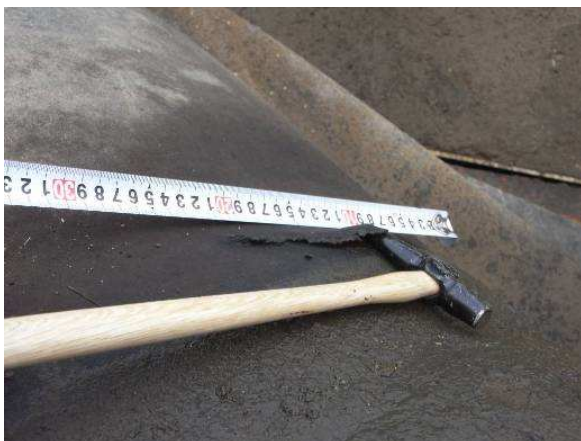
写真-7.1.8 袋体の損傷の例
