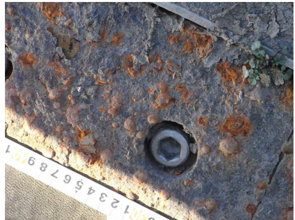
写真-7.1.13 取付金具 (SS400 の場合) の腐食の例
