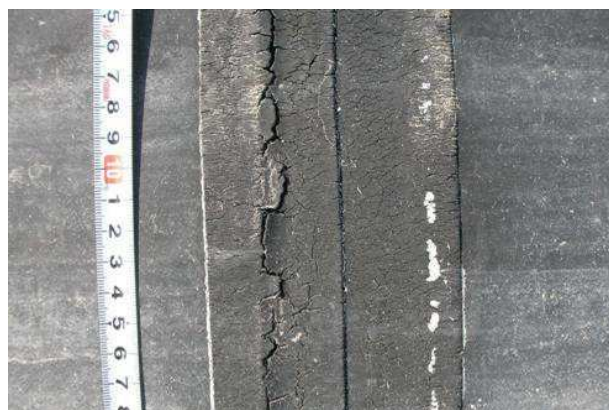
写真-7.1.11 袋体継目の劣化の例
