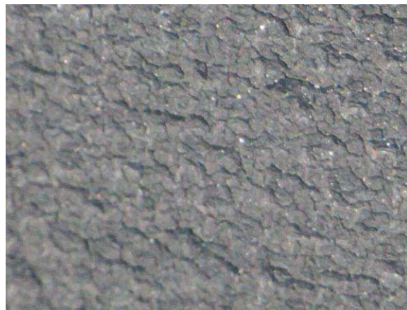
写真-7.1.7 袋体外面の劣化の例
