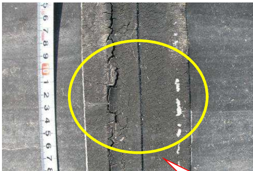
【袋体継目の変状】
