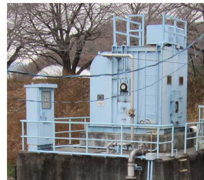
ネット形除塵機全景例
