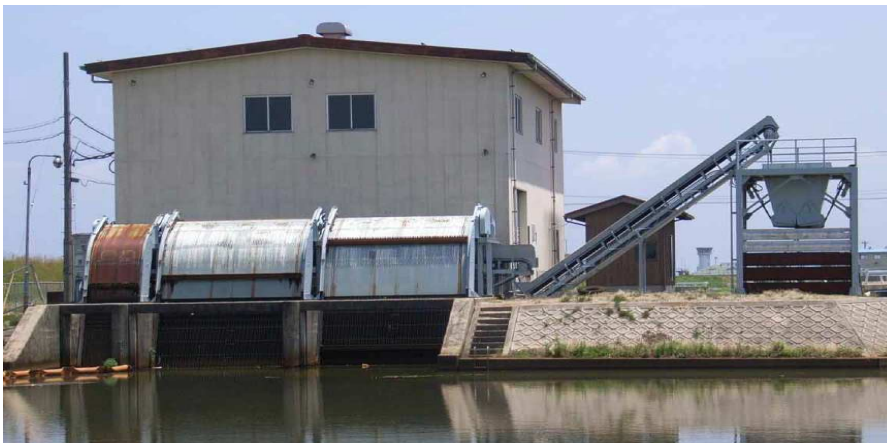
写真-9.1.1 排水機場の除塵機（レーキ形）の設置例
