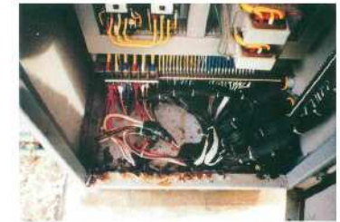
例；盤内の腐食の状態
