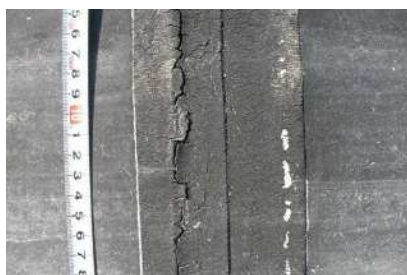
例：継目の変状
