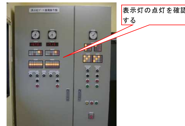
例；機側操作盤の表示確認
