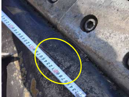
例；袋体に生じた亀裂
