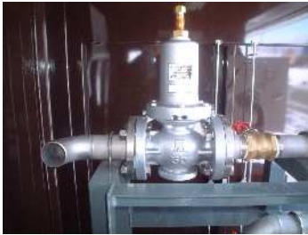
例；加圧防止装置の状況
