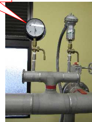
例；圧力計の状況
