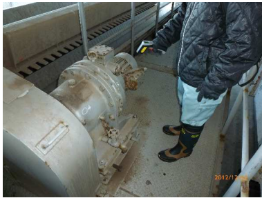
レーザー付き非接触温度計 による電動機温度測定状況
