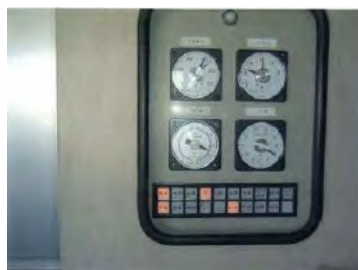
盤面計器による測定
