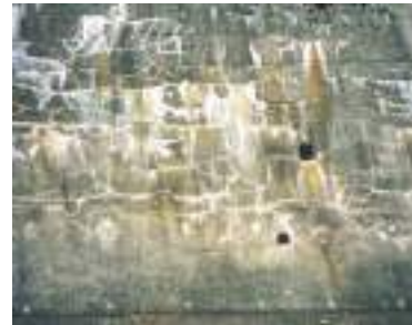
錆汁とゲル（析出物）
