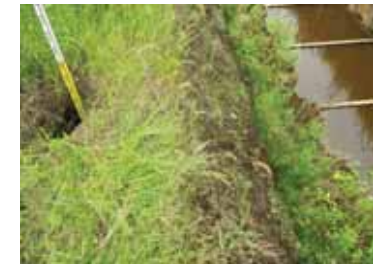
周辺地盤の陥没
