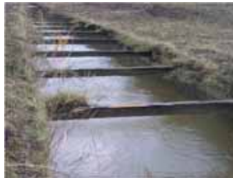
切梁の変状（塗装の劣化）
