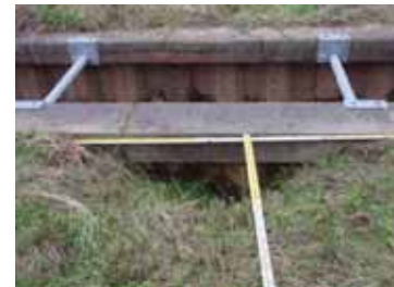
背面土の空洞化
