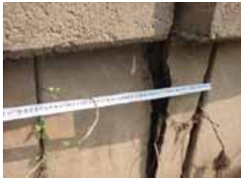
矢板の亀裂・損傷
