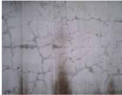
写真-5.2.8 モルタル層のひび割れ
