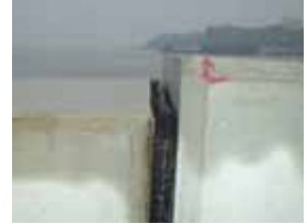
不同沈下による目地の段差
