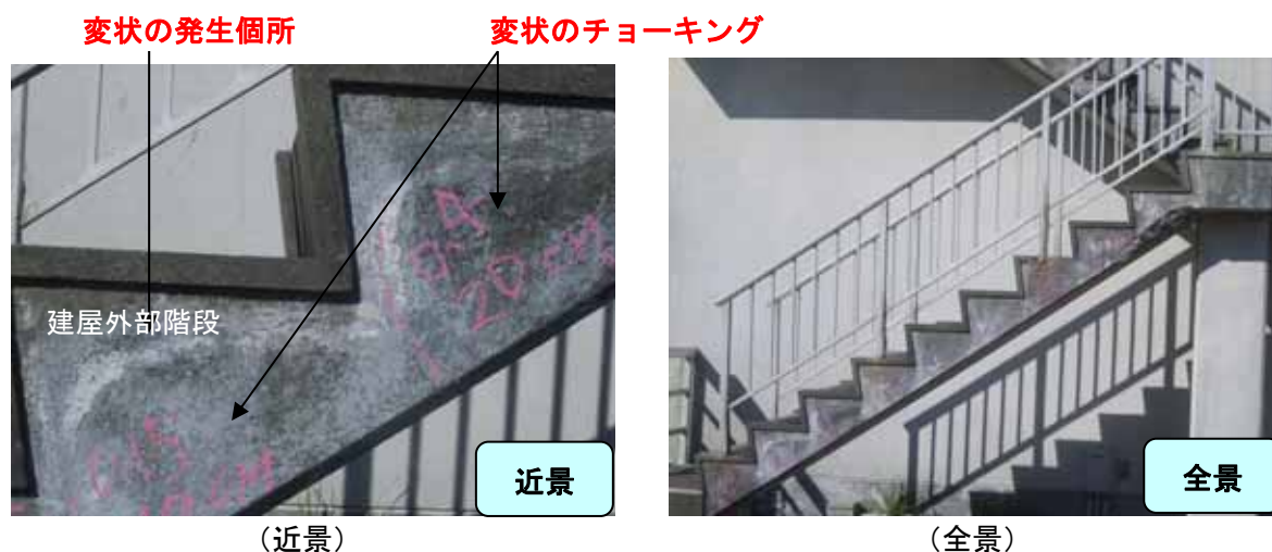
【ポンプ場における代表的な変状の例】
