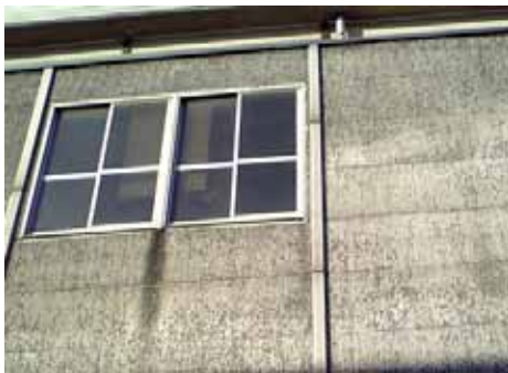
写真-5.2.19 外壁の風化（煤煙、塩害等）
