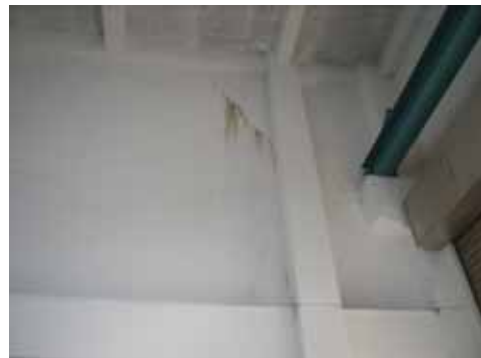
写真-5.2.20 外壁の錆汁
