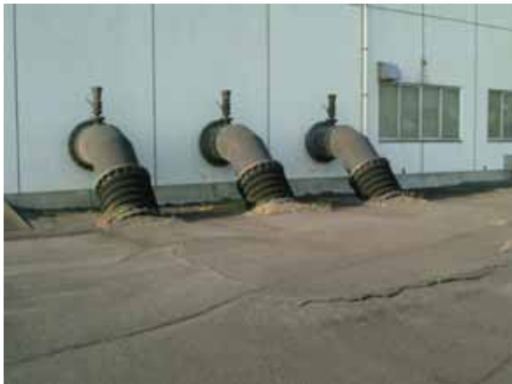
吐水管部周りのひび割れと不同沈下
