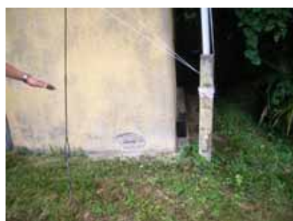
(外壁) 防水層の変状 コンクリート面の欠損 鉄筋露出
