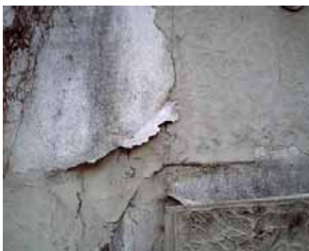
写真-5.2.21 防水層の剥離（外壁）
