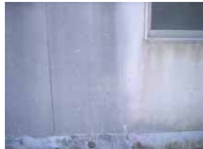
写真-5.2.10 窓開口部ひび割れ
