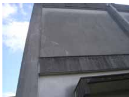
(外壁) ひび割れ 漏水痕跡
