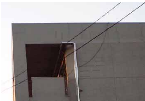
写真-5.2.12 塩害（鉄筋に沿ったひび割れ）
