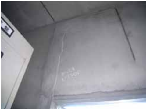
写真-5.2.17 ひび割れ
