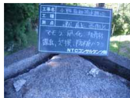
(屋根) 防水層の変状 コンクリート面の欠損
