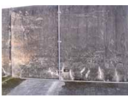
(吐水槽) ひび割れ
