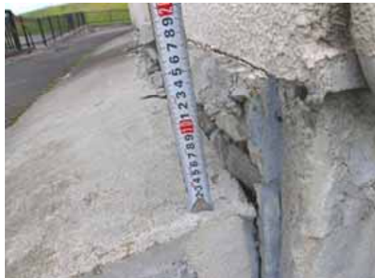
写真-5.2.29 不同沈下による段差計測
