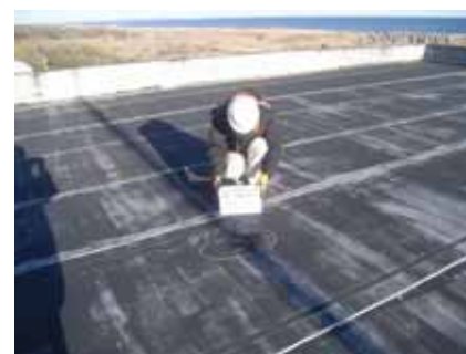
(屋根) 防水層の変状
