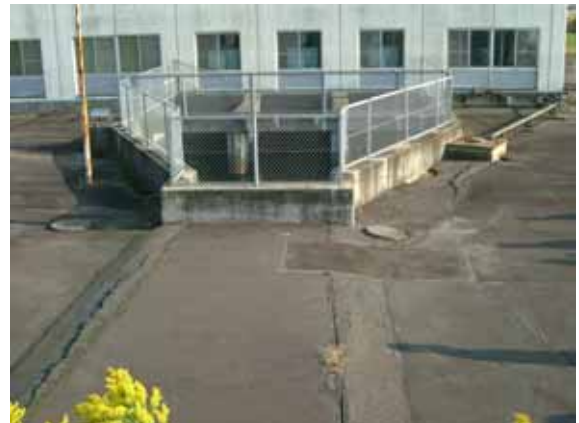
樋函の抜け上がり
