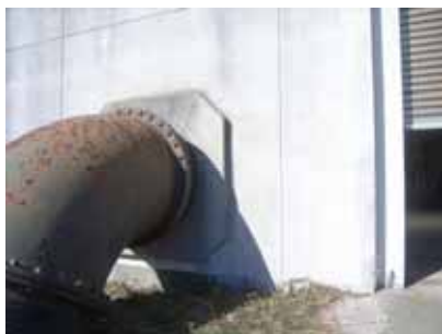
写真-5.2.9 開口部モルタル充填部ひび割れ
