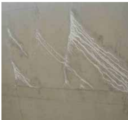
写真-5.2.16 エフロレッセンス
