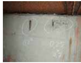
鉄筋の露出（被り不足）
