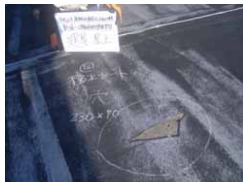
写真-5.2.22 防水層の剥離（屋根）
