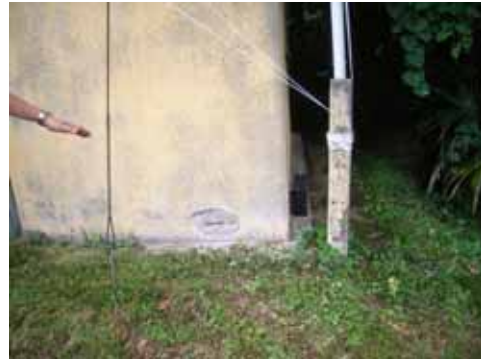
写真-5.2.18 欠損、鉄筋露出
