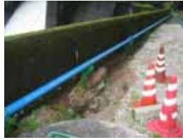
水路側壁周辺の陥没
