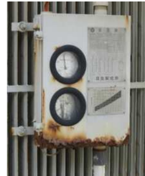
例；計器盤の発錆 塗装の剥がれ
