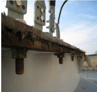
変圧器（屋外）の発錆
