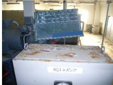
盤外面の塗膜劣化（錆、はがれ）
