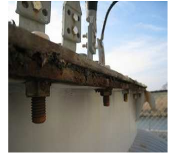
例；変圧器盤（屋外）の発錆
