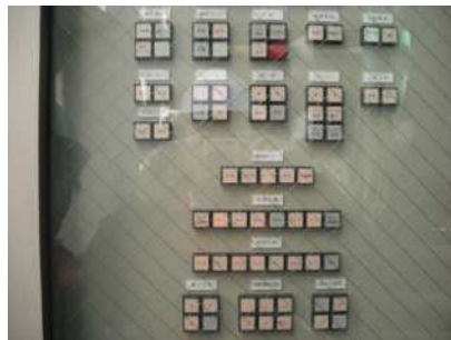
盤表示部の故障（表示灯のランプ切れ）
