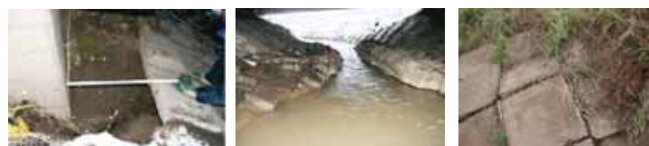
背面土の空洞化
