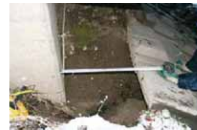
背面土の空洞化
