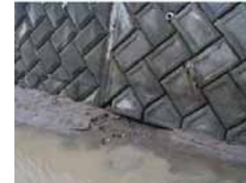
水路底面の洗掘
