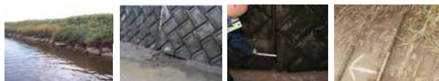
ブロックの欠損
