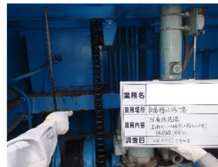
レーキチェーン（除塵機）の動作確認
