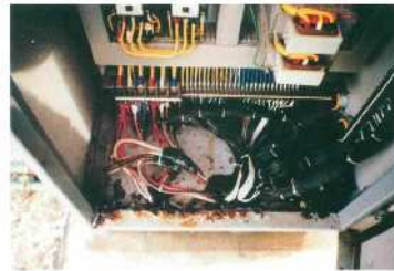
例；盤内の腐食の状態
