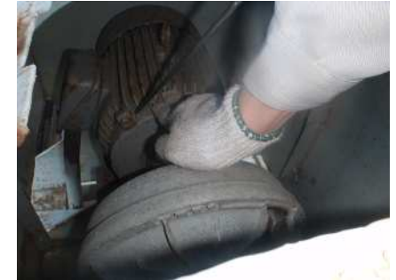
除塵機（電動機）の振動・過熱確認
