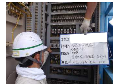
3E リレー（機側操作盤）動作確認
