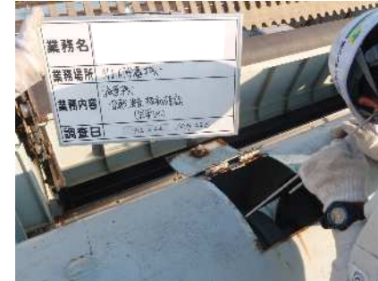
除塵機（減速機）の異常音確認
