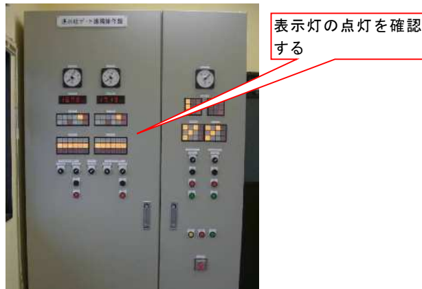
例；機側操作盤の表示確認
