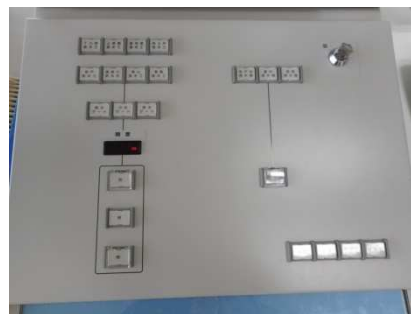
監視操作卓（操作部）
