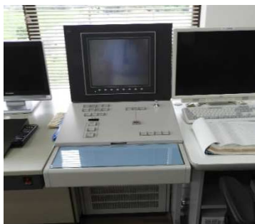
監視操作卓 (入出力中継装置実装)
