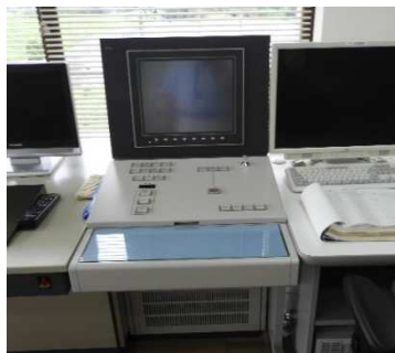
監視操作卓（全体）
