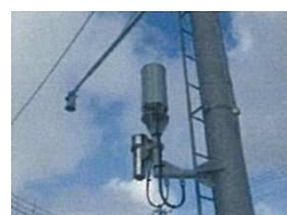
雨量計（柱上設置）
