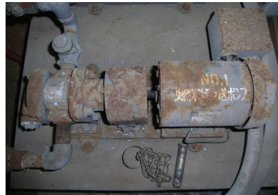
例；軽度の腐食
