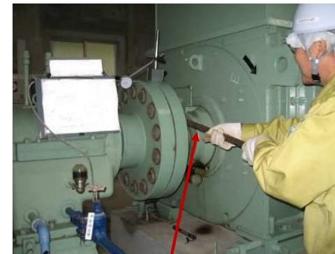
ターニングバーによる確認
