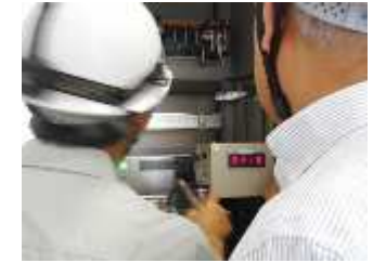
盤内表示装置確認
