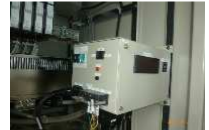
盤内状況（現場計測データ表示装置）
