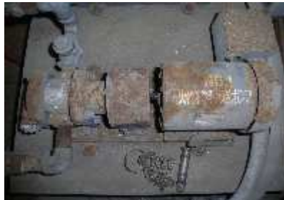
例；軽度の腐食
