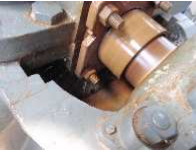
ポンプ軸封部（水漏れ有）
