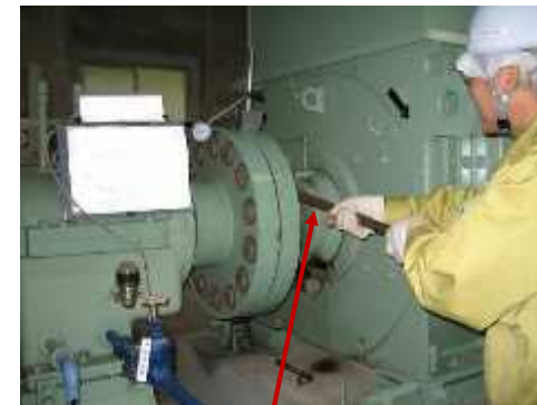
ターニングバーによる確認
