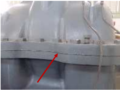
ポンプケーシング合わせ面（水漏れ無）
